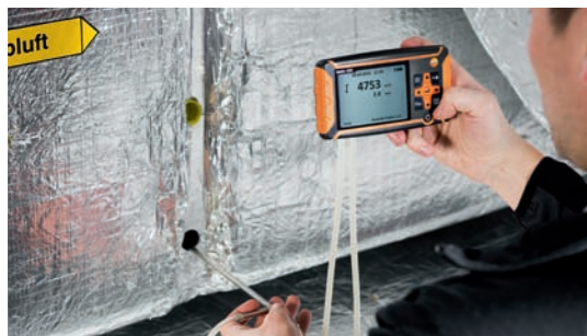
Измерение в вентиляционном канале с помощью трубки Пито.
