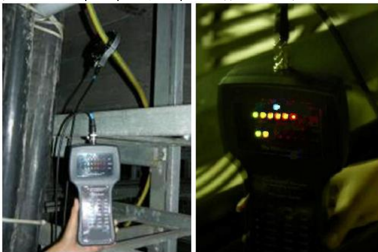
Рисунок 10: PDSurveyor™ с HFCT на проводе заземления кабеля компрессора электродвигателя N2, показывающий на HFCT (20 000 pC) свечение 6 светодиодов (КРАСНЫЙ 1)
