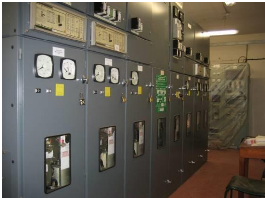
Распределительное устройство на 11 кВ
