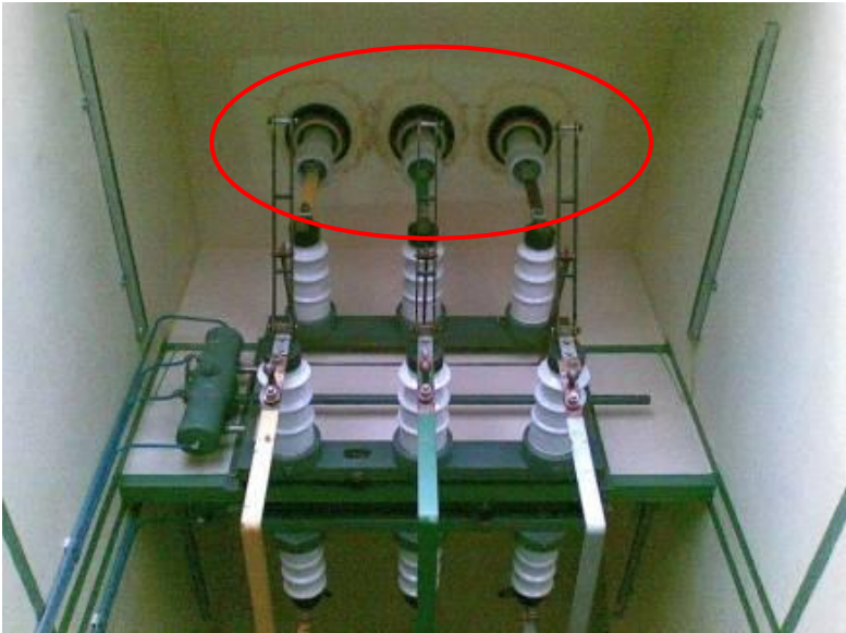
Рисунок 9: Повреждение от воды на изолирующих втулках T42 30 kV отсека 2
