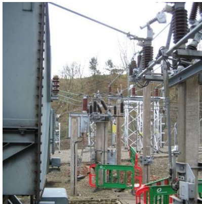
Наружная сторона подстанции
