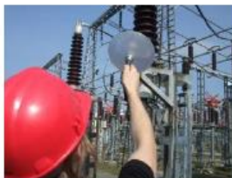
Тестирование изоляции вне помещения с помощью приемника с внешней параболической антенной
